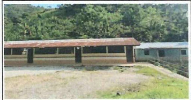
Foto 4: En esta fotografia se ve el techo frontal y el espacio de juego , por lo que es necesario su mejoramiento y reparacion.
