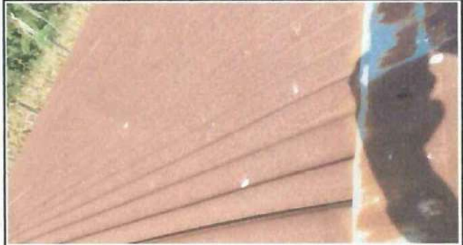
Foto 2: Se ve que las láminas tiene varios agujeros que permite la entrada del agua al aula.
