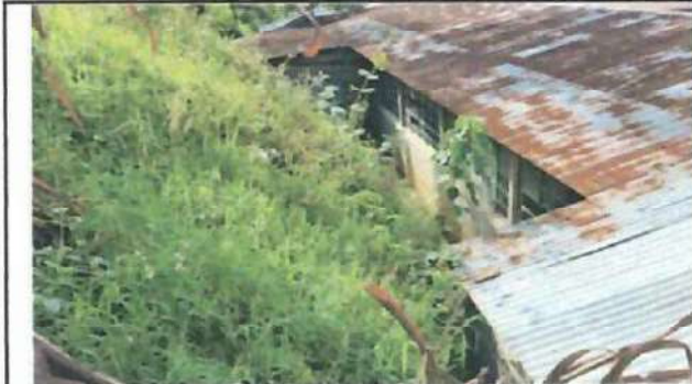
Foto 1: Aquí se evidencia que el techo del Ineb de telesecundaria esta muy deteriorada.
